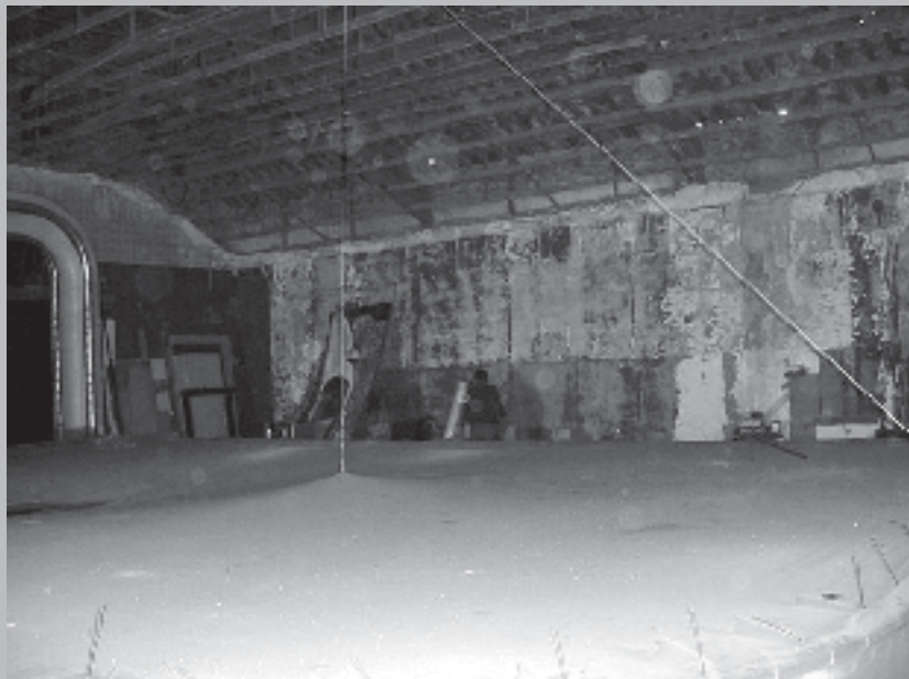
L'ESTAT ACTUAL DEL SOSTRE ÉS LAMENTABLE. A LA IMATGE PODEM OBSERVAR LES PARETS HUMITEJADES I L'ESTRUCTURA DEL SOSTRE DE LA SALA D'ACTES.
