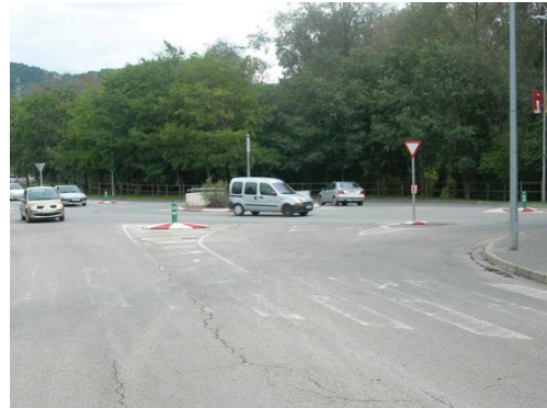
Senyalització horitzontal en estat deficient
