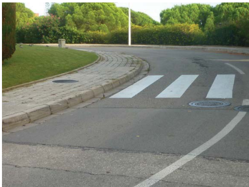
Imatge 21. Carrer de Lluís Companys. Vorada no rebaixada.
